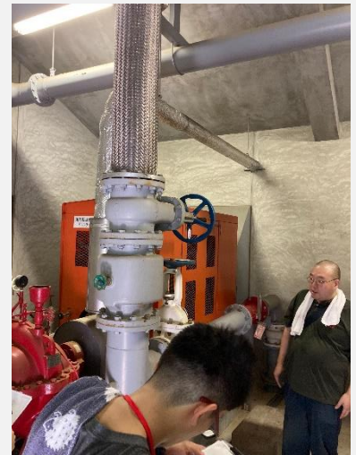
▲消火ポンプ室
